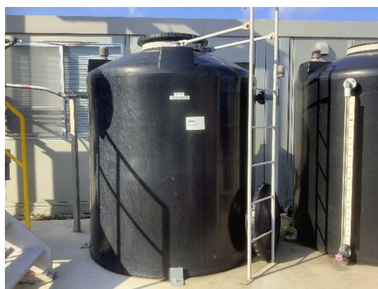
UF膜濃縮液肥貯留槽（左）
